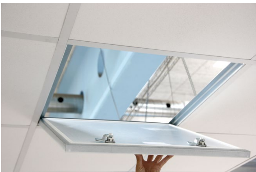
Snadný přístup k technickému zařízení budovy.
